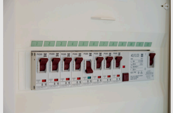
Boîte à fusibles
