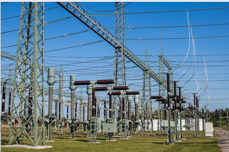
Centro de transformación
