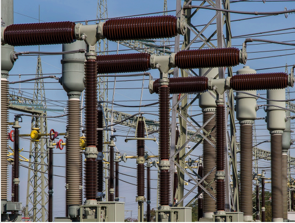
Transformateurs dans une sous-station
