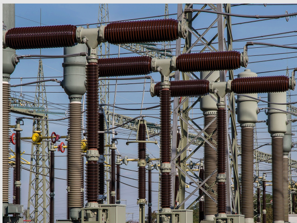
Transformateurs dans une sous-station
