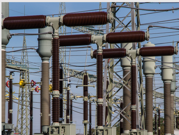
Трансформаторы на трансформаторной подстанции
