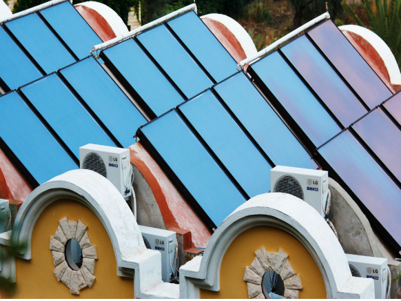
Sonnenkollektoren auf einem Dach
