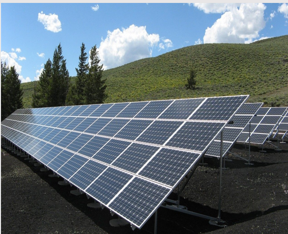
Solarzellen zur Erzeugung elektrischer Energie
